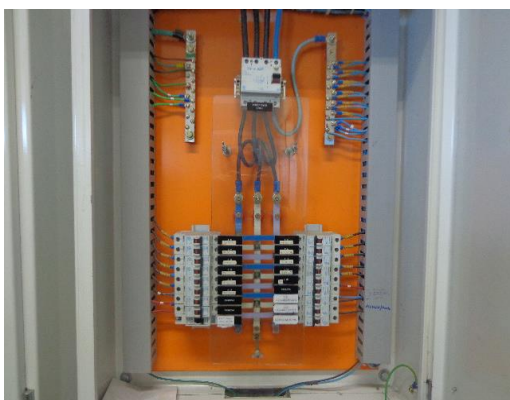
Quadro de Distribuição – CERTO ✓
