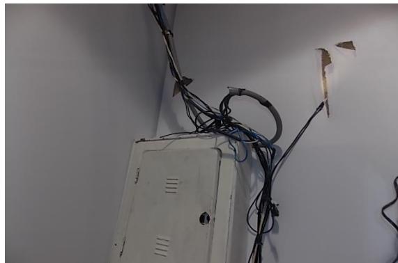
Quadro de Distribuição – ERRADO X
