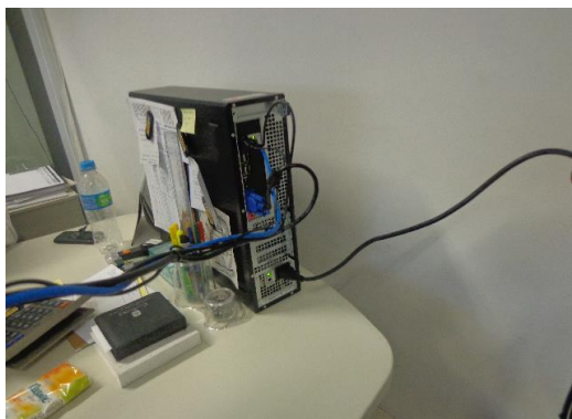
Dados/Vozes separado da Elétrica
