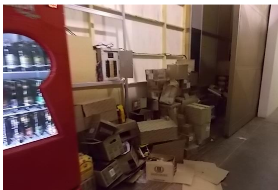
Quadro de Distribuição – OBSTRUÍDO X
