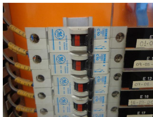
Disjuntor Normal – 10 A
